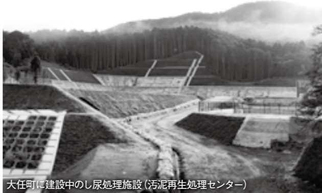
大任町に建設中のし尿処理施設(汚泥再生処理センター)
