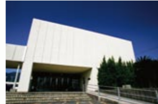
↑ 老朽化で雨漏りをしていた方城分館。
