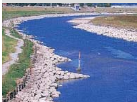
↑災害復旧工事により、多自然型川づくりが行われた上野橋下流の護岸。
