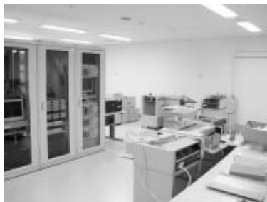
▲方城支所(2階)にある電算(サーバー)室。
