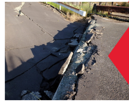
↑車両移動が不可能になった熊本地震の道路崩壊。
