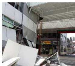
熊本地震で押し潰された建物
