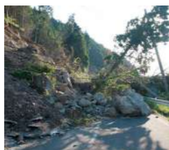
熊本地震で寸断された道路
