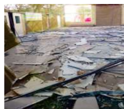
熊本地震で落下した天井
