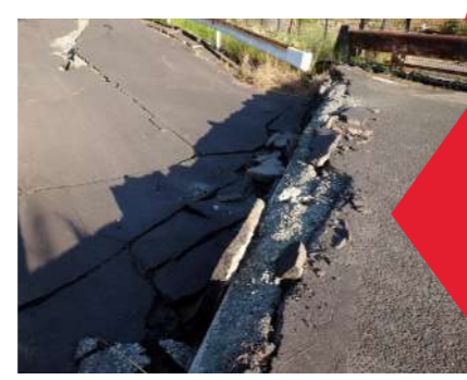
↑車両移動が不可能になった熊本地震の道路崩壊。
