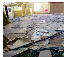
熊本地震で落下した天井
