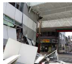
熊本地震で押し潰された建物
