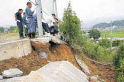
グラウンドの斜面が崩落した伊方小学校、翌日の3日に町消防団が応急処置。
