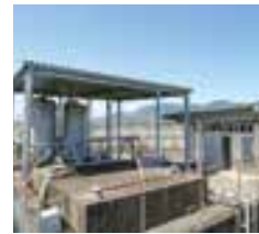
東中古門専用水道浄水場
